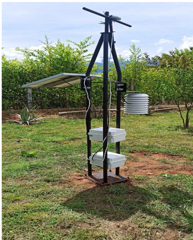
Ilustración 12. Instalación de la Estación Meteorológica en la Finca Buena Vista (La Plata-Huila).
